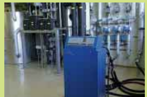
Le banc d'essai du Centre WPZ de Buchs (SG) pour les pompes à chaleur eau-eau et saumure-eau est utilisé depuis le début de l'année.
