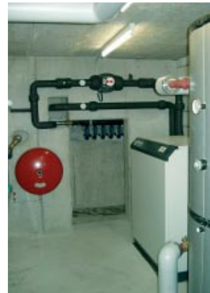
Vue du local de chauffage. En rouge: le vase d'expansion du circuit des sondes. En noir: le départ et retour du circuit des sondes. En beige: la pompe à chaleur de 53 kW. En gris: l'accumulateur technique de 2000 litres.
