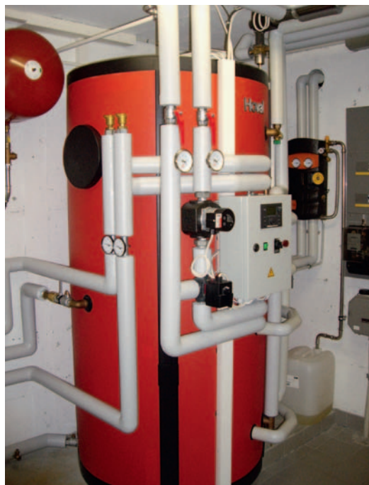
Accumulateur combiné d'une contenance de 523 l pour le chauffage et de 300 l pour l'eau chaude sanitaire.
