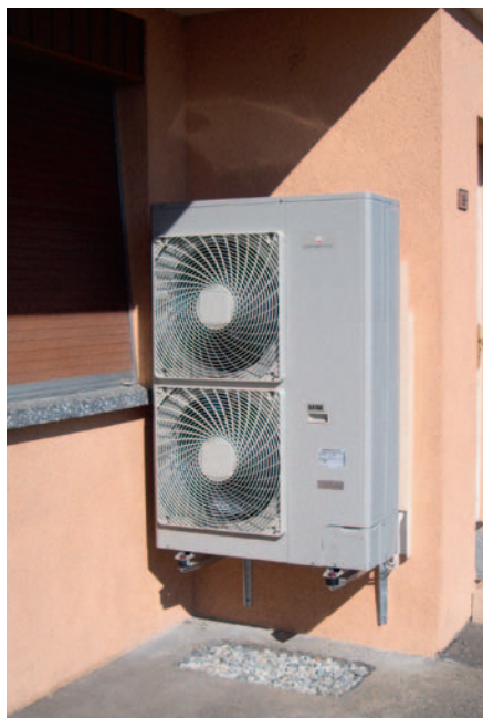
Partie extérieure de la pompe à chaleur.
