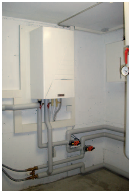
Partie intérieure de la pompe à chaleur.
