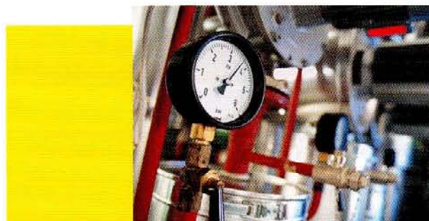
Manomètre sur une pompe de distribution.
