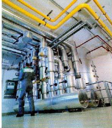
Technicien de service d'EBM devant la partie distribution d'une centrale de chauffage.
