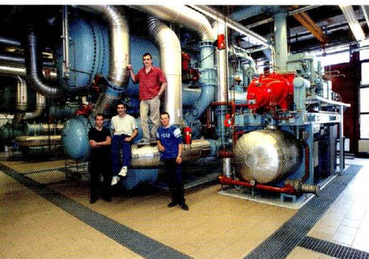
Fig. 2: PAC «calculée». Les 2 x 4,5 mégawatts thermiques assurent le chauffage du site de l'EPFL. © EPFL, Alain Herzog
