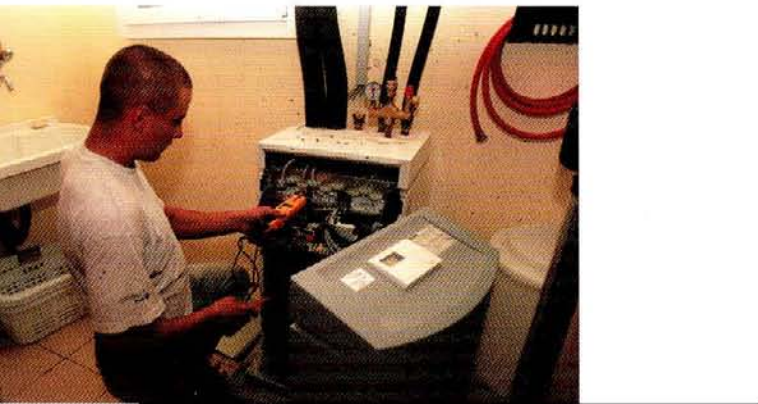
Contrôle de mise en service.
