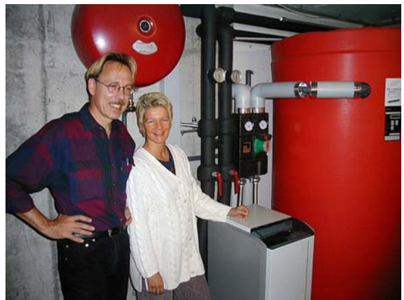
Pompe à chaleur avec sonde géothermique et production d'eau chaude sanitaire
