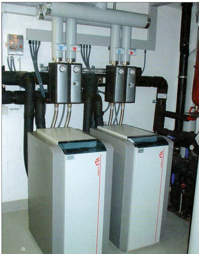
Installation modèle d'une double PAC sol-eau, avec ses conduites bien isolées.
