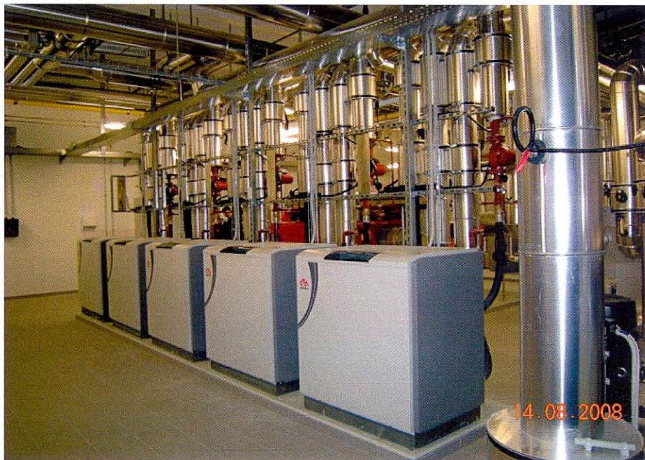
Installation de 500 kW de puissance thermique en suisse romande. Ces 5 pompes à chaleur puisent leurs énergies dans le sous-sol pour chauffer et refroidir le bâtiment.
