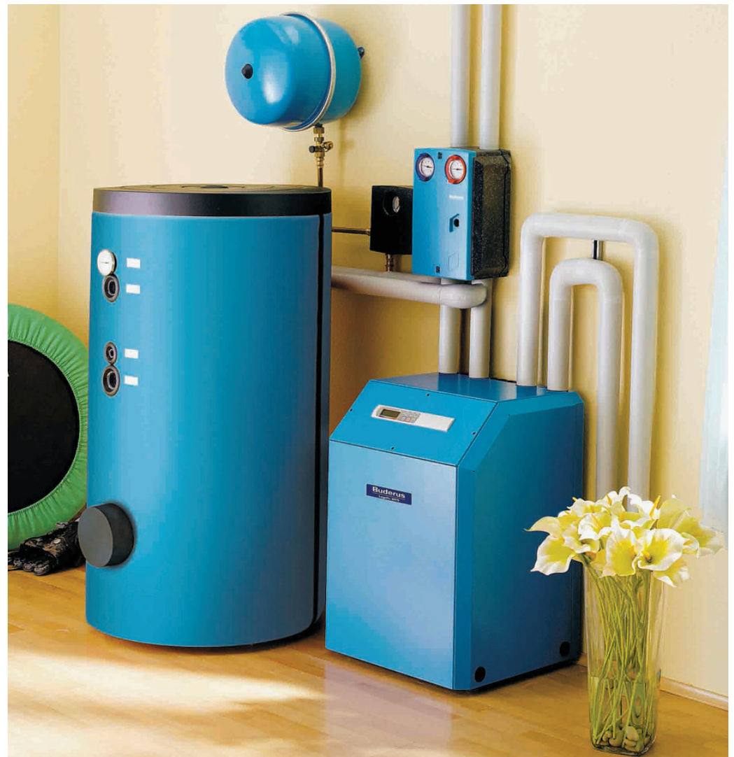
Outre les avantages économiques et écologiques qu'elle présente, une pompe à chaleur (ici PAC sol-eau) prend relativement peu de place, même avec un boiler associé pour la production d'eau chaude.
